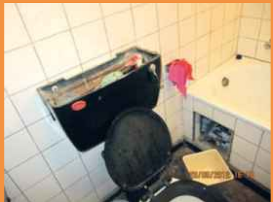
A broken toilet
